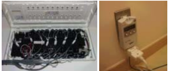
(1) 分電盤 (2) コンセント
