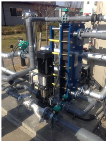
地下水汲み上げ用ポンプ
