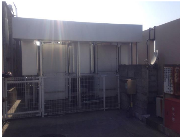
空調用室外機及び給気用ダクト
