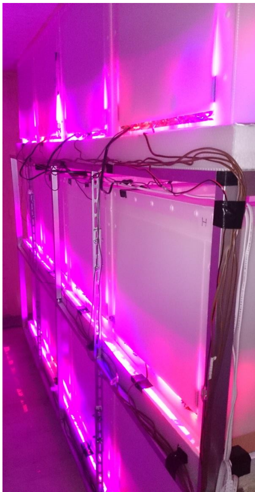
図 栽培設備①の外観
